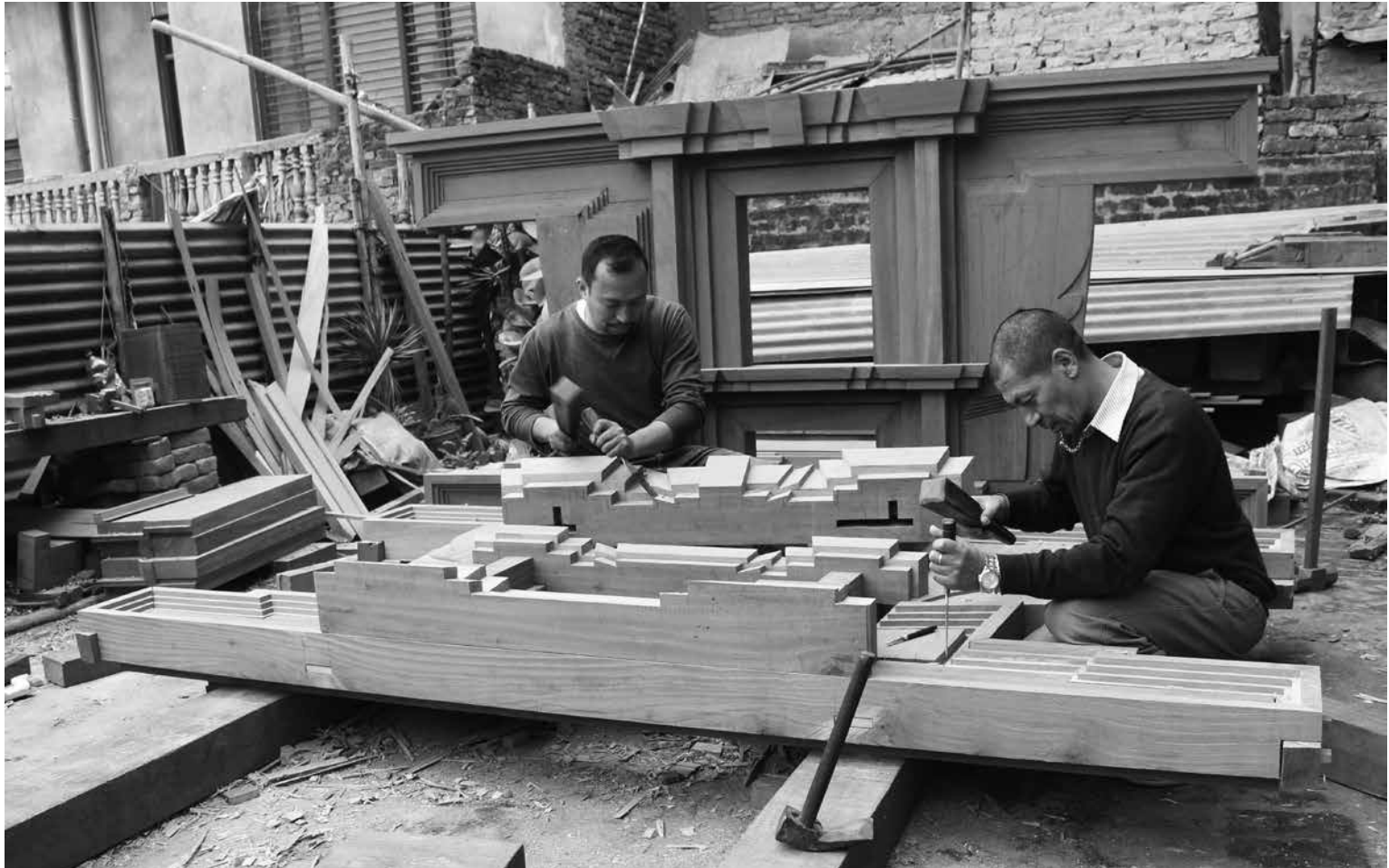
Indra Prasad mit seinem Vater Indra Kaji bei der Herstellung der Fenster für den Bhaidegah Tempel in Patan, 2018.
